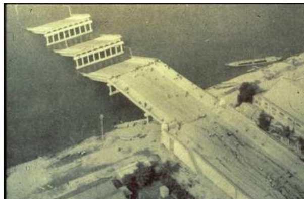
Séisme de Niigata –Japon 1964 [26]
