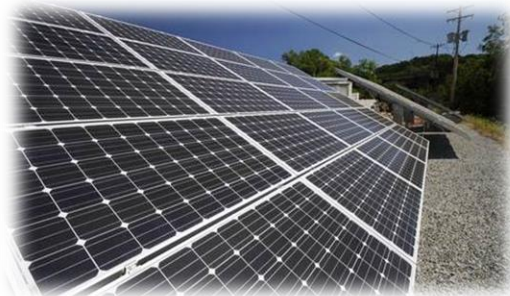
Figure 2. 51: les capteurs solaires photovoltaïques. Source : https://www.blog-habitat-durable.com .
