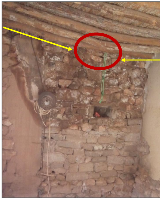
الشكل(144): صورة توضح تلف بوسط عارضة السقف.
