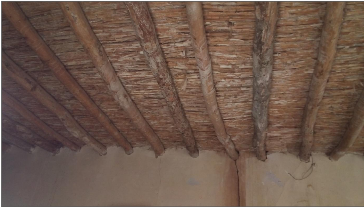
الشكل(149): صورة توضح تلف طبقة الحصير بالسقف. المصدر: من إعداد الطالبتين.
