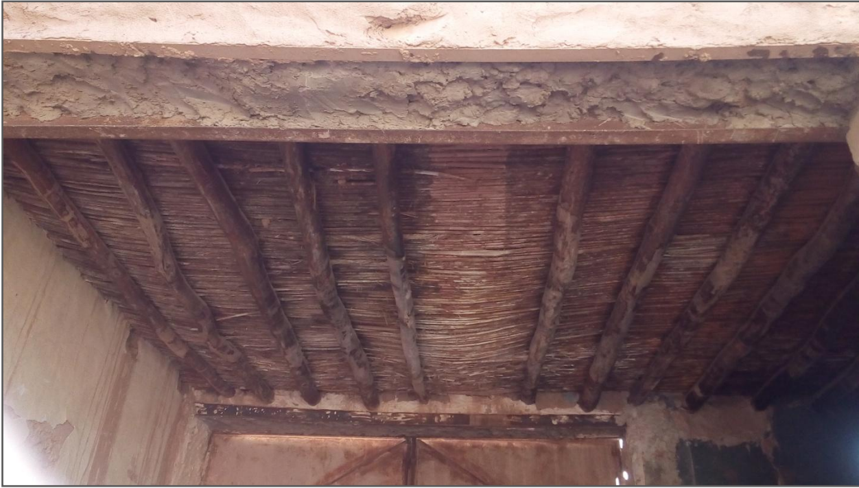
الشكل(148): صورة توضح تلف طبقة الحصير بالسقف. المصدر: من إعداد الطالبتين.
