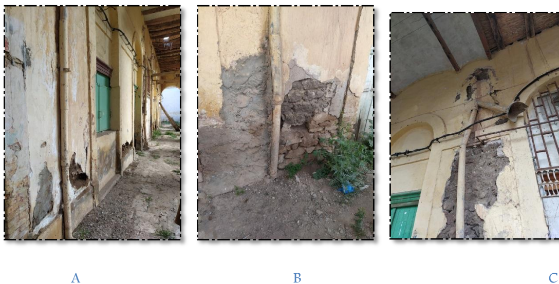
Figure 3 : dégradation des descentes d'eau .source : auteur.
