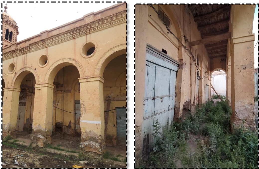
Figure 1 : état de conservation du beffroi. Source : auteur.
