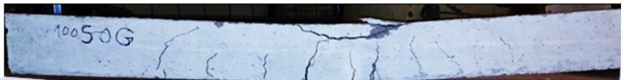
Figure III.15 : Schémas de fissuration de la poutre (BS100G0).
