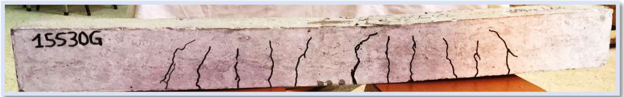
Figure III.18 : Schémas de fissuration de la poutre (BS15G30).
