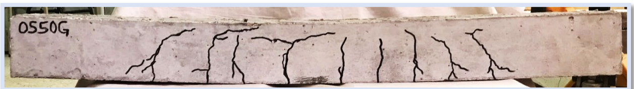
Figure III.16 : Schémas de fissuration de la poutre (BS0G50).
