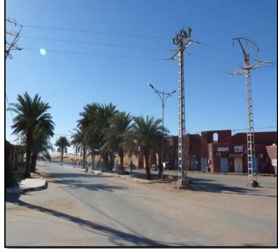
الشكل رقم 32 : صورة لأعمدة الانارة العمومية بالكهرباء المصدر : ملتقطه من طرف الطلبة
