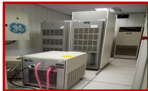
شكل 48 : غرفة المولدات الكهربائية للجهاز الرنين المغناطيسي
