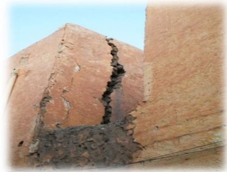
Figure 11 : dégradation du bâti Source : les étudiants
