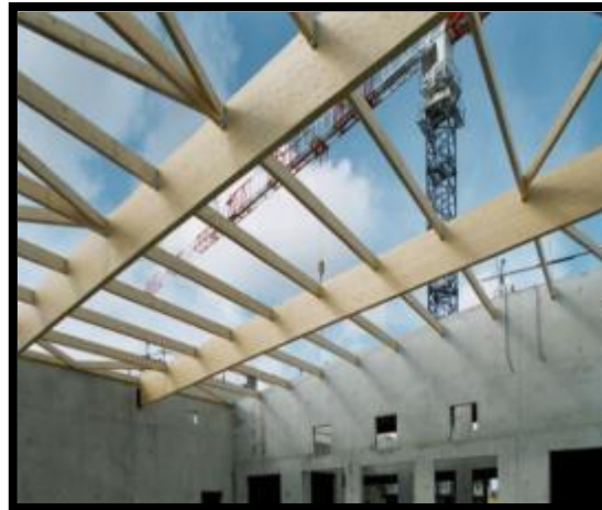
Figure 57 : Salle EPS (Ossature Bois) [Source : http://www.Atlas_des_colleges.com ]
