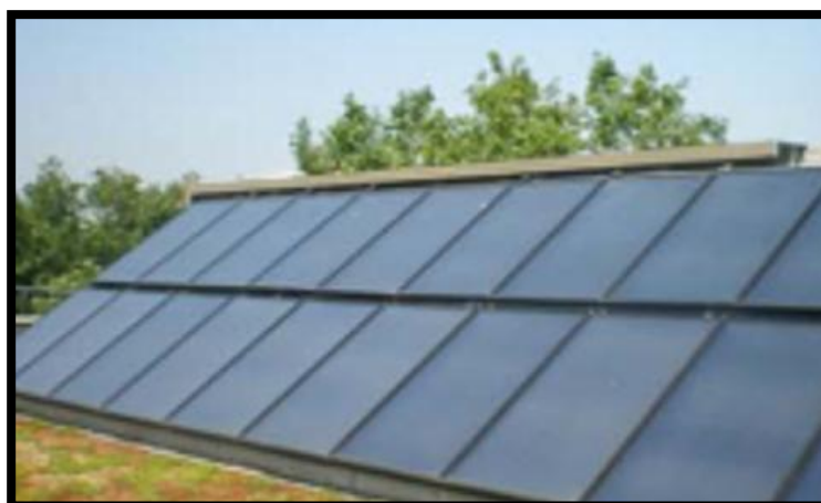
Figure 48 : Panneaux solaires du collège
