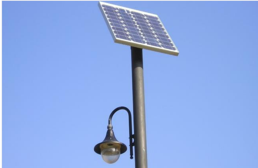
Figure 134 : Poteau actionné solaire de lampe, www.google-image.com
