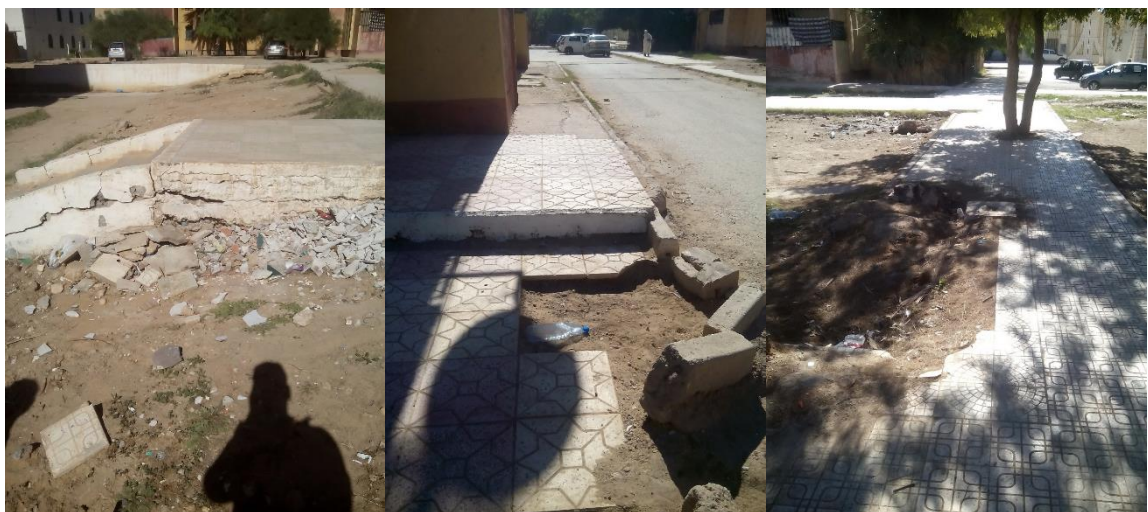
Photo 30 : Dégradation des trottoirs
