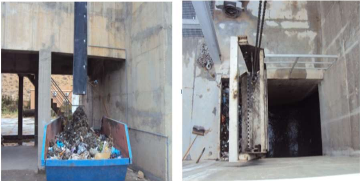
Figure I- 2 le dégrillage STEP de Laghouat ( Photo Original ,2018 ).
