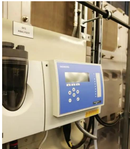
Figure 89: Systèmes de control d'eau du projet. Source : www. thecrystal.org
