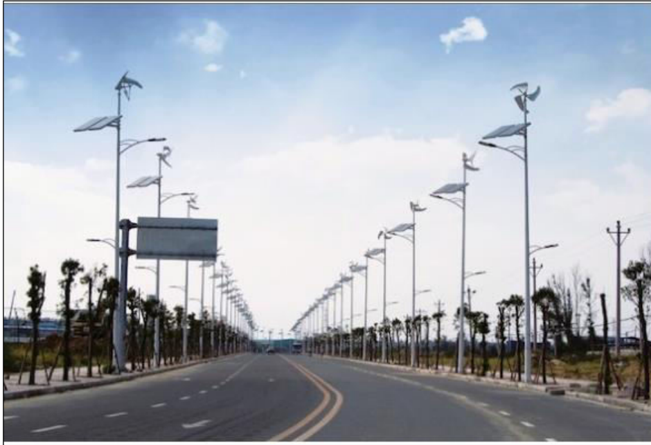
Figure 26 : Des lampadaires à vent et photovoltaïques Source : Google image
