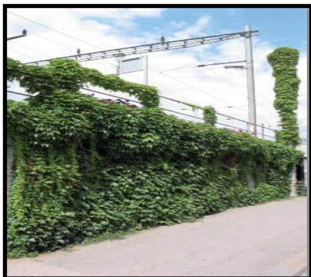
Grand mur colonisé par la végétation.
