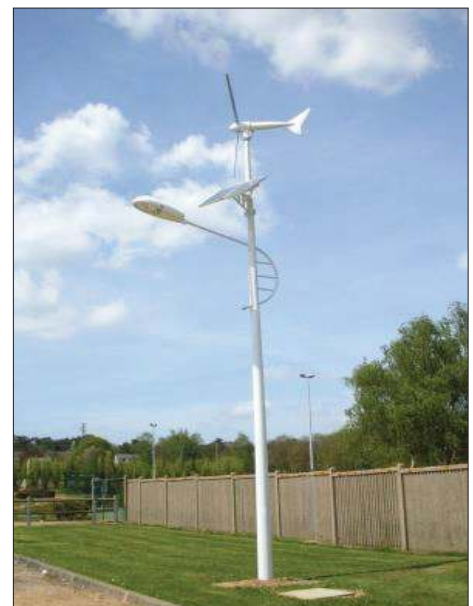
Photo 86: poteau d'éclairage autonome Source : Google image
