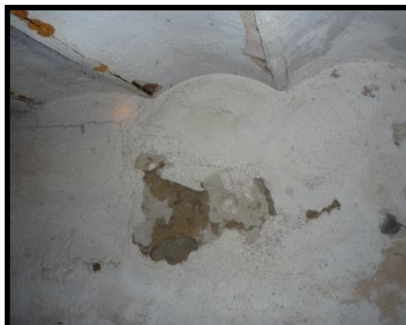
Figure I.30 : Dégradation de l'enduit des murs Source : MEMOIRE de M. AIT HAMOUDA Ibrahim 2012 - 2013
