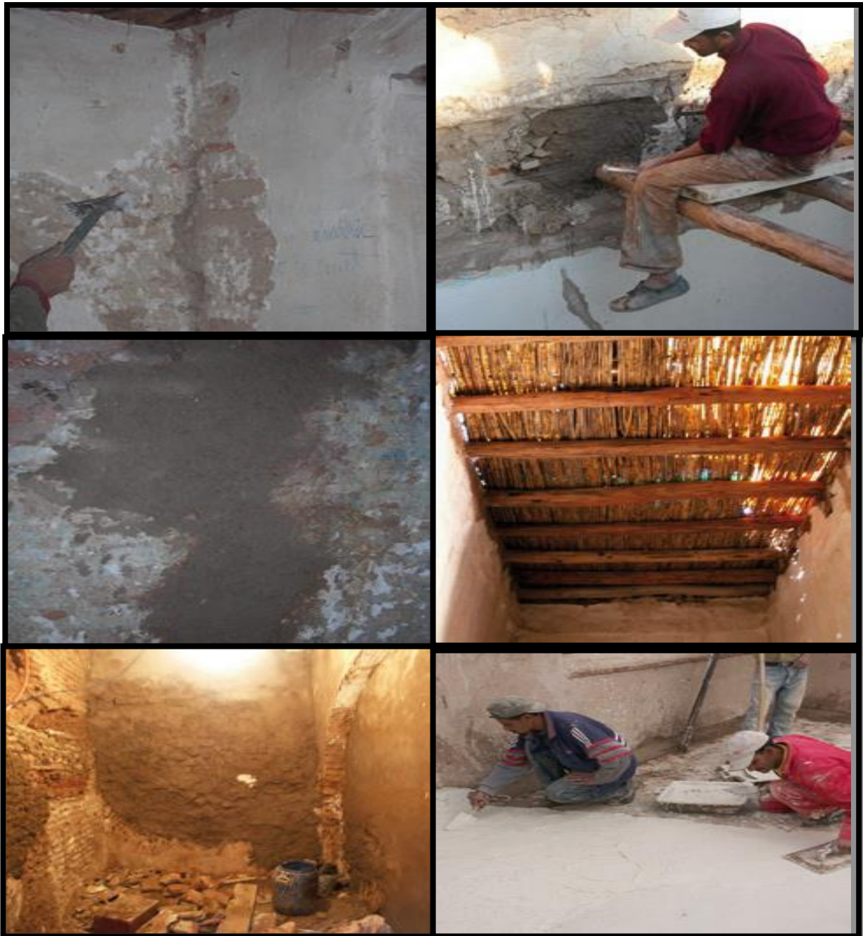
Figure I.47. : Renforcement structurel des murs et Reprise des planchers Source : RehabiMed, Réhabilitation et action sociale à Marrakech, Maroc
