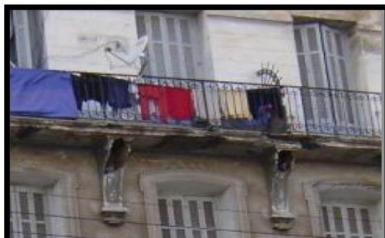
Figure I.29 : Dégradation du nez du balcon filant et des consoles décoratives sur la façade principale Source : MEMOIRE de M. AIT HAMOUDA Ibrahim 2012 - 2013
