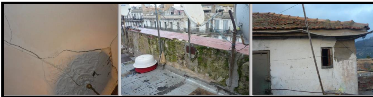
Figure I.31. : Dégradation de l'enduit de l'acrotère et de la couverture en tuile et Fissure d'un faux plafond
