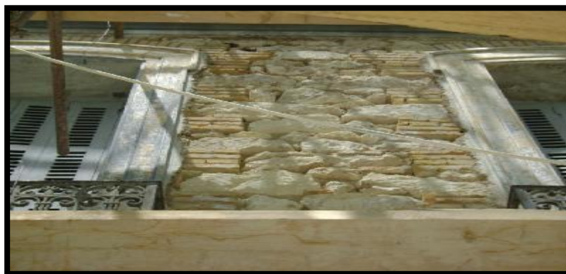
Figure I.32 : Décroûtage des enduits sur la façade Source : MEMOIRE de M. AIT HAMOUDA Ibrahim 2012 - 2013auteur
