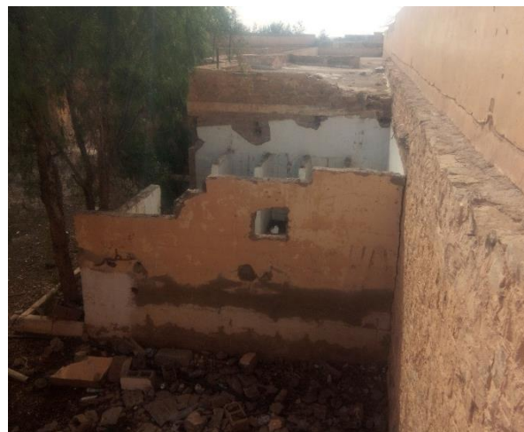
Photo 48 : toit démolie - Source : l'auteur
