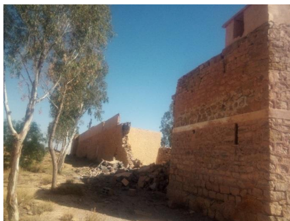
Photo 46 : la façade gauche est en mauvais état –Source : L'auteur
