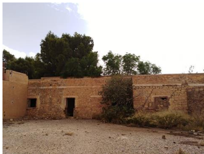
Photo 52 : Bloc B en mauvaise état - Source : l'auteur
