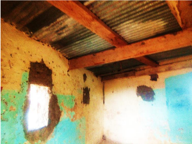
Photo 56 : effondrement de plancher et le risque d'étalement non étudié -Source : L'auteur
