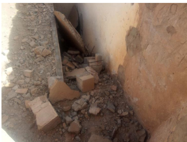
Photo 49 : mur terrasse démolie - Source : l'auteur
