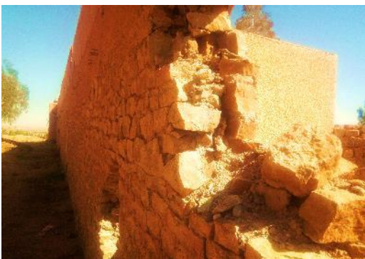
Photo 55 : Grande partie de mur démolée Source : L'auteur
