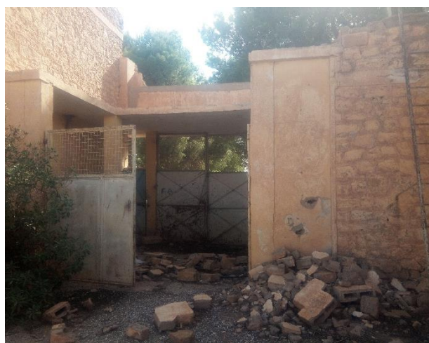
Photo 50 : mur terrasse démolie - Source : l'auteur
