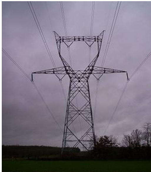
Figure II.8 : Pylône THT pour une ligne de 400kV
