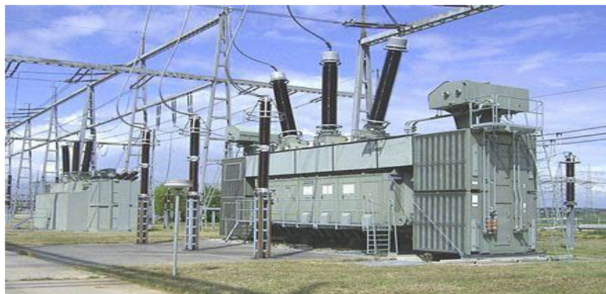
Figure II.11 : Transformateur de puissance d'un poste électrique HT
