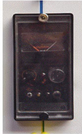
Figure II. 10: Contrôleur Permanent d'Isolément
