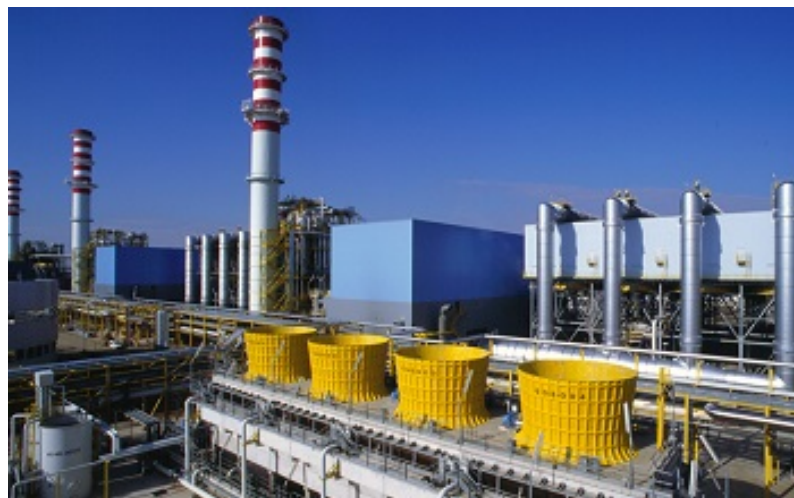
Figure I.3: Centrale thermique au gaz
