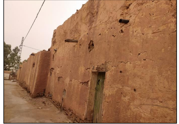
الشكل 101 :صورة توضيحية لمنازل تحتاج الي ترميم
