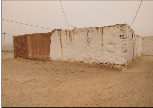
الشكل 102 :صورة توضيحية لمنازل تحتاج الي ترميم
