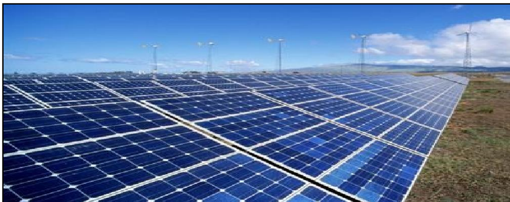
Fig ( I.9) : Panneaux Solaires Photovoltaïque [9]
