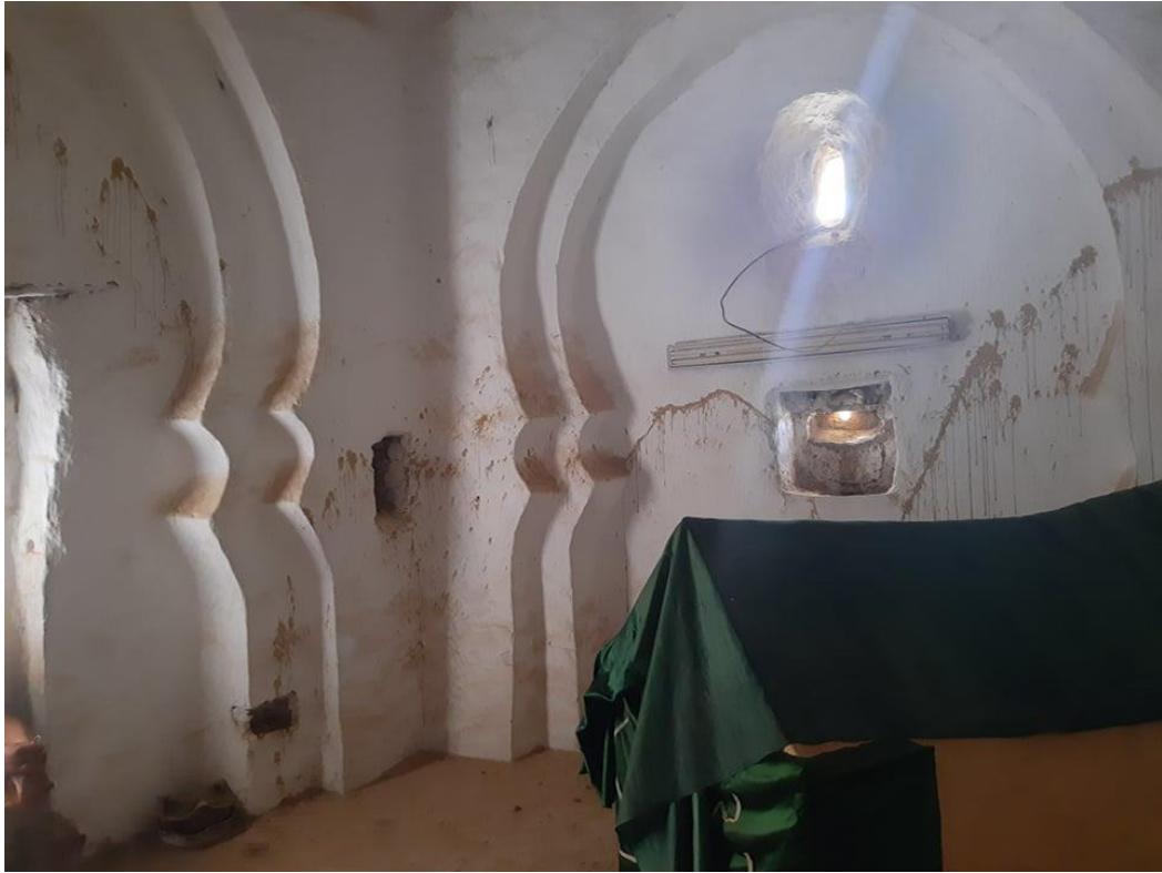
صورة رقم 69: وجود أملاح على مستوى الجدران الداخلية المصدر: الباحث
