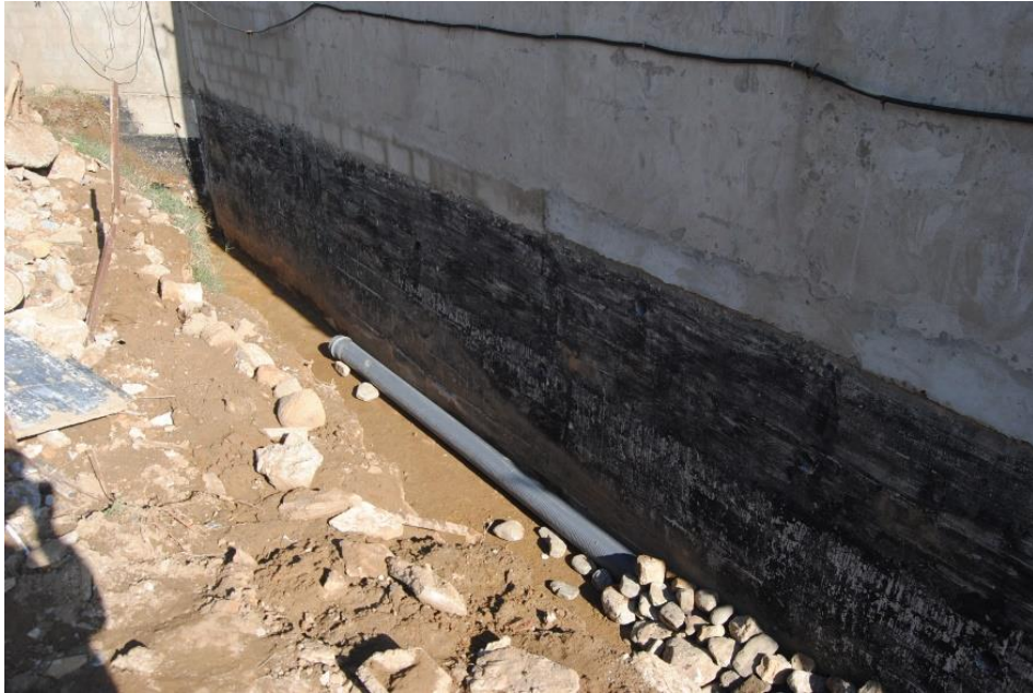
تصريف مياه الامطار اسفل الأساسات
