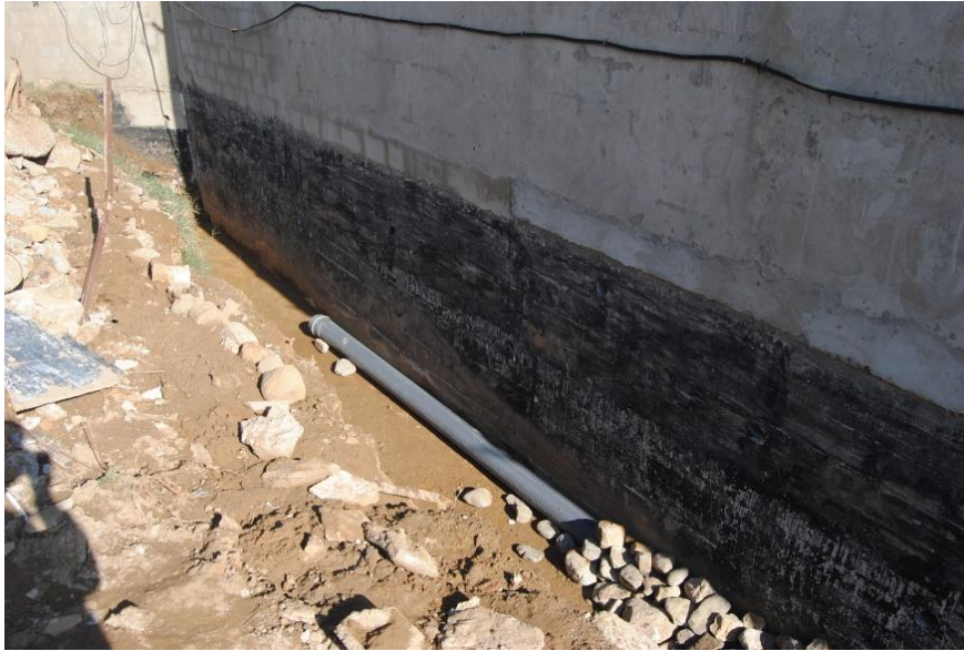
صورة رقم 132: تصريف مياه الامطار اسفل الأساسات
