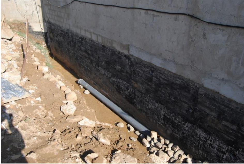
صورة رقم 75: تصريف مياه الامطار اسفل الأساسات المصدر: الباحث
