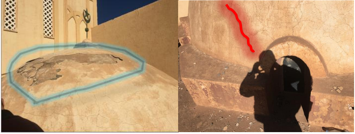
صورة رقم 125: شروخ إنشائية و شروخ سطحية المصدر: الباحث
