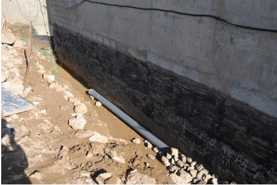
صورة رقم 111: تصريف مياه الامطار اسفل الأساسات المصدر: الباحث
