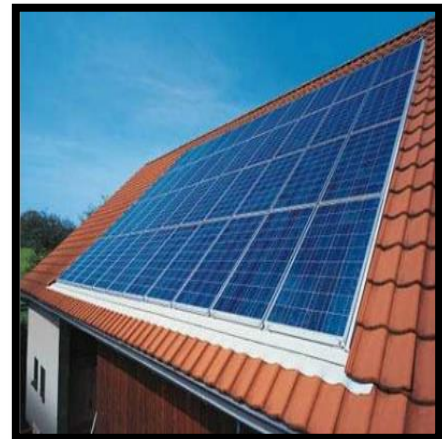
Figure(47): Les panneaux solaire source: wikipedia.org
