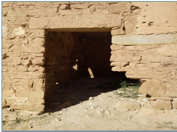
Figure 208: : dégradation de porte extérieure Source : Auteure
