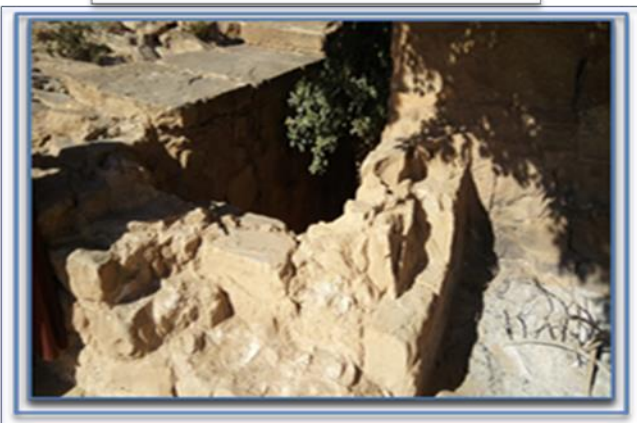
effondrement d'une partie du mur
