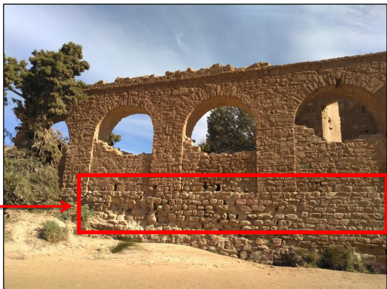
Figure 233: les traces d'eau dans le mur du moulin hydraulique source : Auteure
