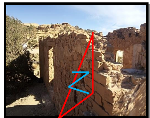
Figure 180 : dégradation du mur source : Auteure
