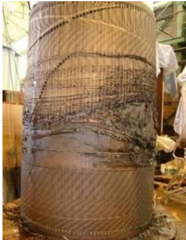
Figure. II.6 Amorçage franche entre spires [2]
