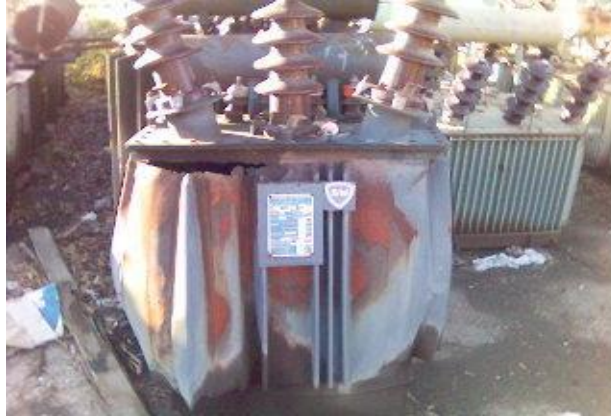
Figure II.4 Défaut à cause d'une foudre [4]
