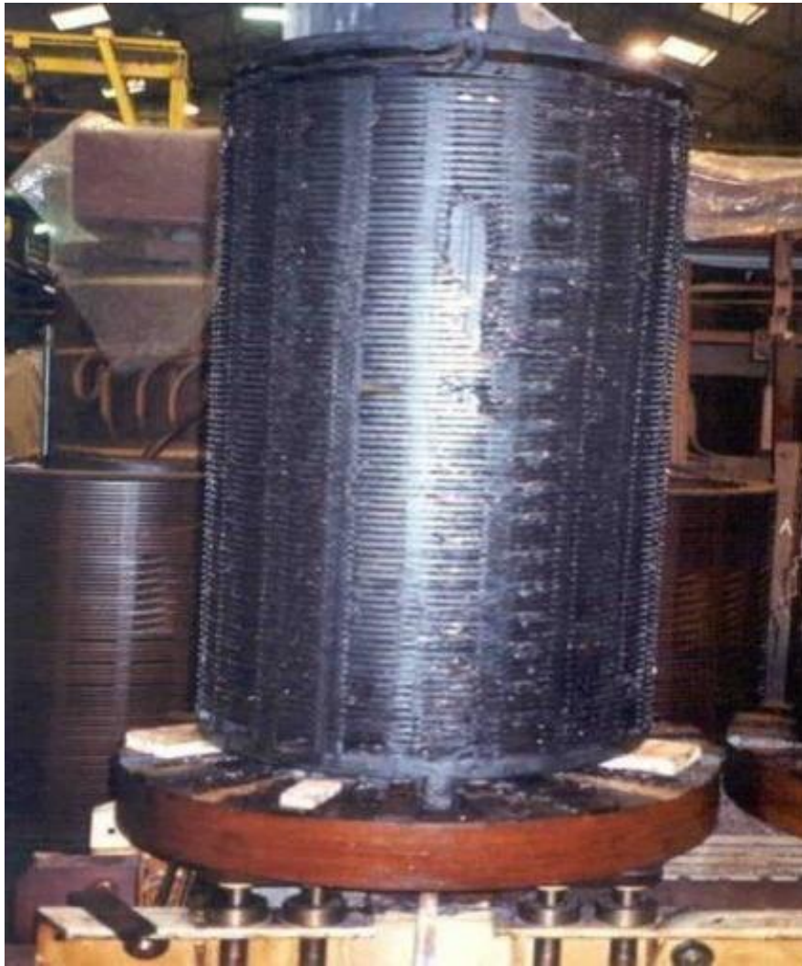
Figure. II.9 Échauffement excessive d'un enroulement [2]
