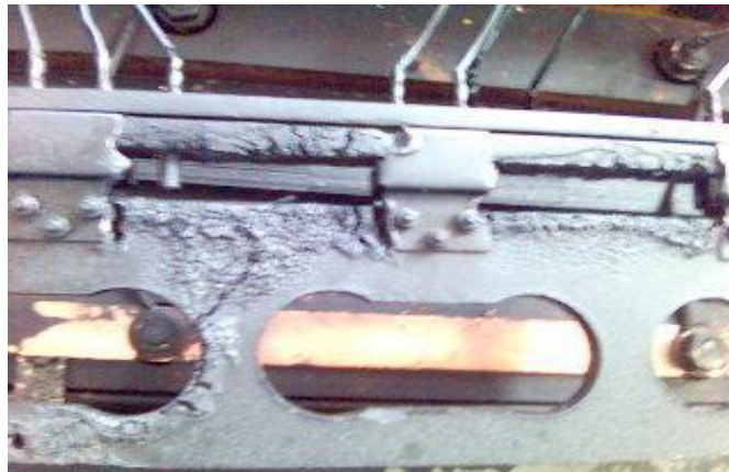
Figure II.2 Défaut de circuit magnétique « déformation » [4]
