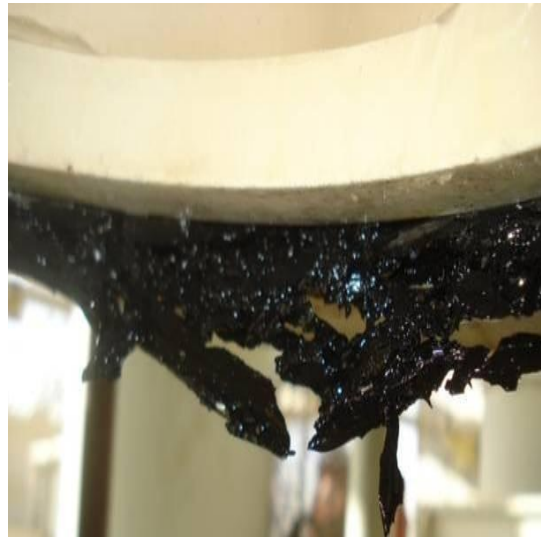
Figure. II.12 Joint de traversée écrasé [2]
