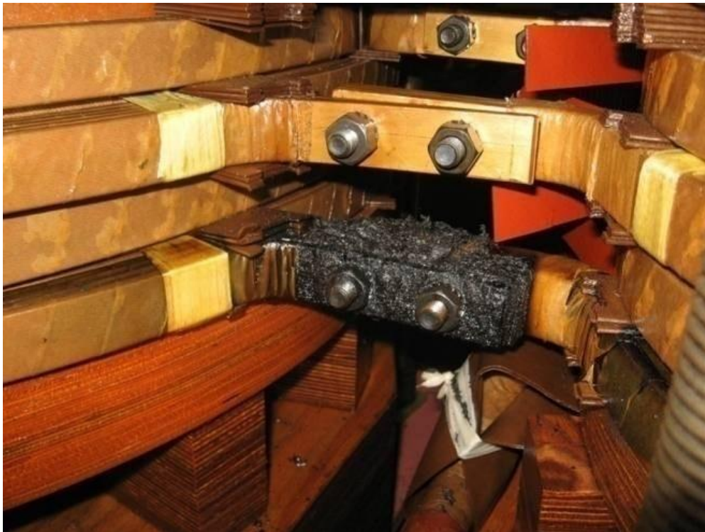
Figure. II.8 Point chaud sur connexion boulonnée [2]
