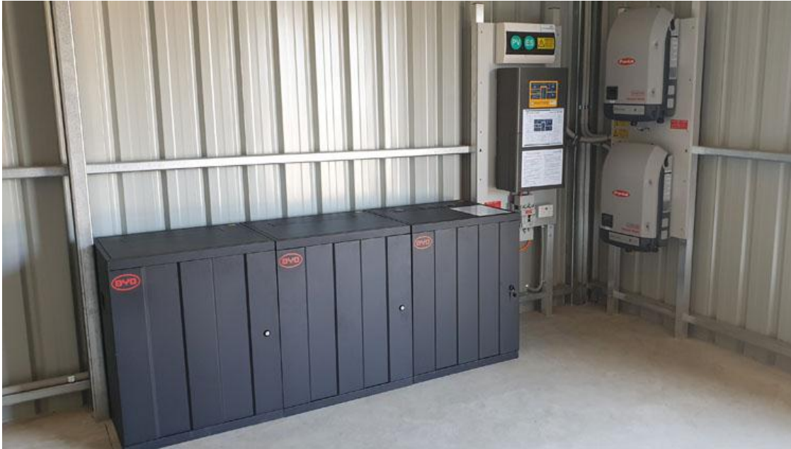
Figure II.7. Un système autonome utilisant des batteries lithium-ion (de G à D : armoires de batterie, onduleur/chargeur, onduleurs solaires) (Photo: © Off-Grid Energy Australia).
