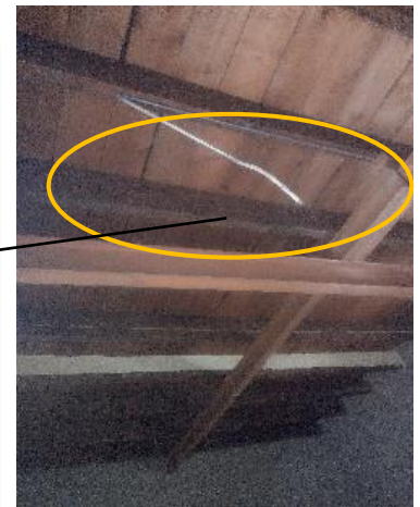
réseau électrique (chambre)
