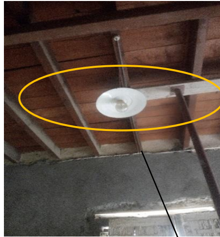
Détérioration du réseau électrique (chambre)
