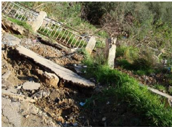
Figure 1.22: glissement de terrain dans la wilaya Constantine [6].
