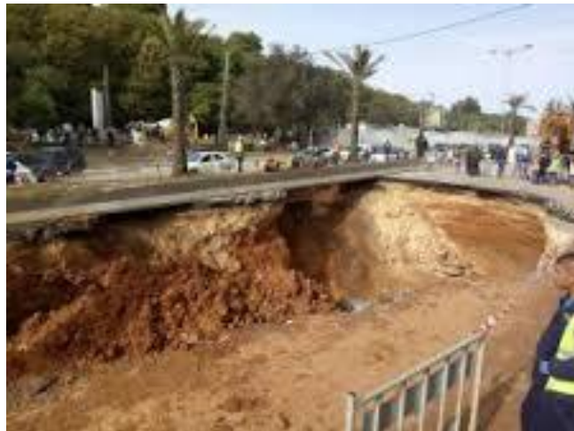
Figure 1.7 : Affaissement de terrain à Ben Aknoun (Alger)[6]
