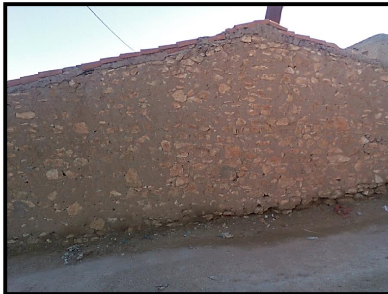
Image 6: représente les matériaux de construction des murs dans une maison traditionnelle Source : l'auteur
