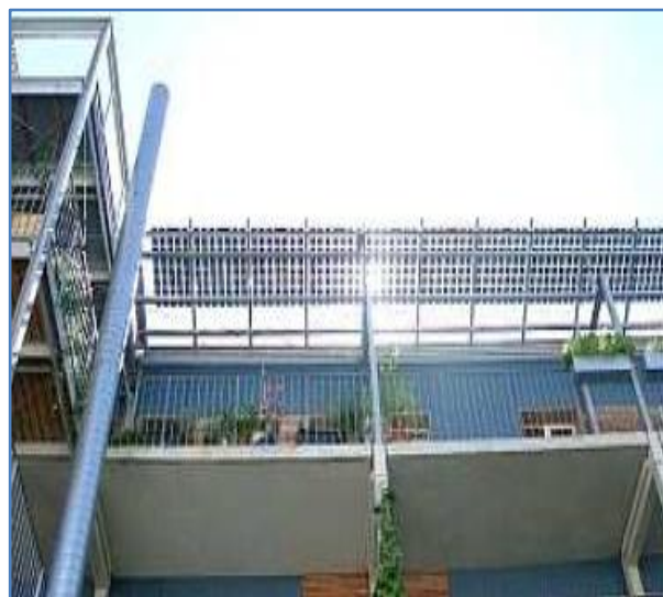
Figure 45 : Toiture avec panneaux photovoltaïques. Source : (Quartier Vauban Compte-rendu, visite du Service du logement & des gérances - UL, 06-10-2006).
