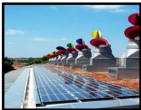
Figure28: les panneaux photovoltaïques
