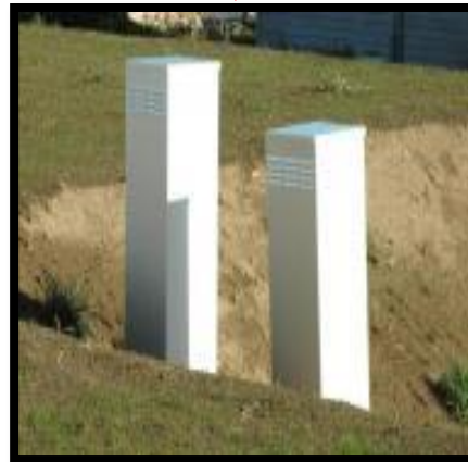
Figure 63 : la sortie de puit canadienne de la maison, Source : http://lab-immo.ch/1037/ Minergie-P-ECO MAISON
