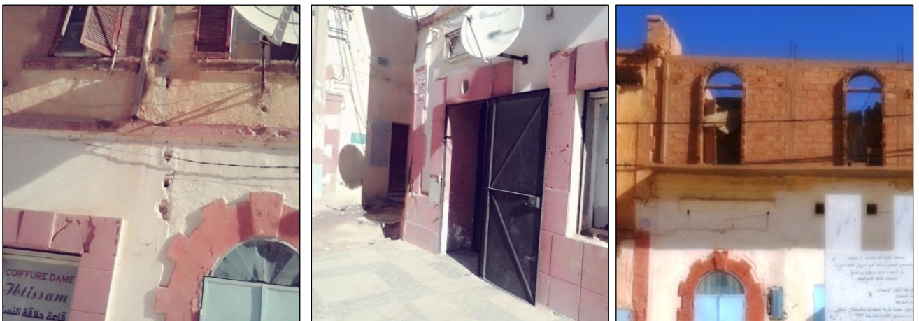
Figure 101-102-103 CH III: les pathologies de la façade nord de la place de l'étoile (prise par les étudiantes)
