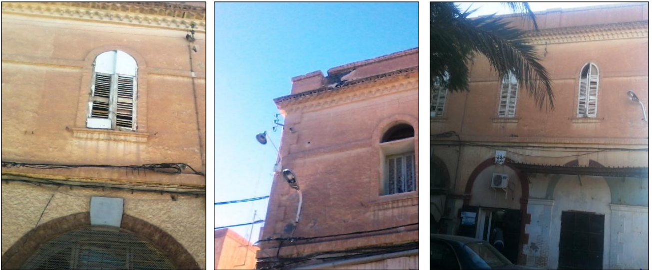
Figure 116-117-118 CH III: les pathologies de la façade sud de la place Randon (prise par les étudiantes)
