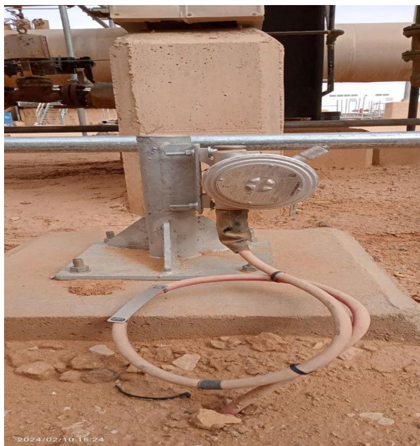
Figure 26: Mauvaise fixation des câbles ATEX et câblage ATEX non protégé à ras du sol extrêmement exposé aux chocs mécaniques
