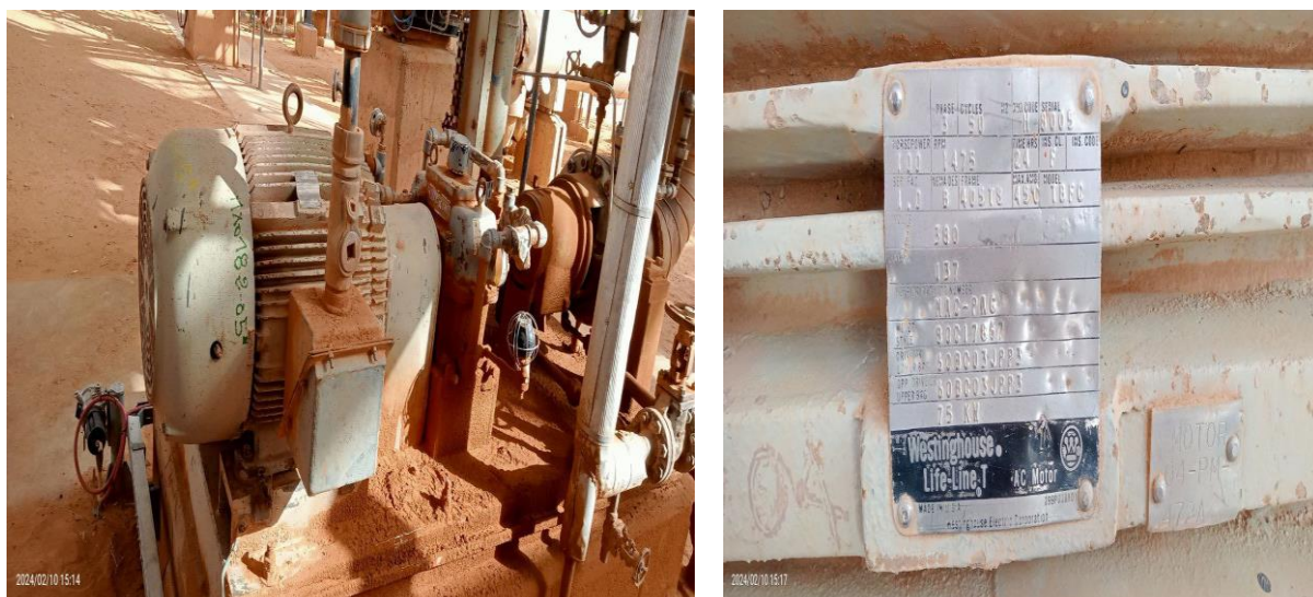
Figure 25: L'existence d'une pompe non ATEX dans une zone considérée comme une zone 2
