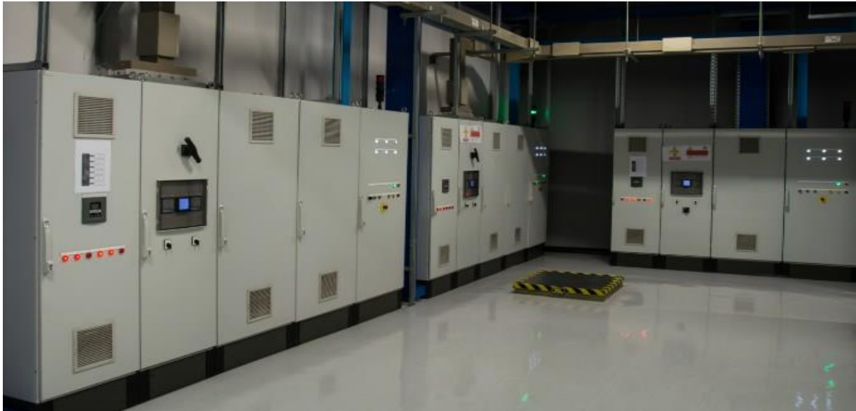
Figure 11: panneaux de distribution électrique
