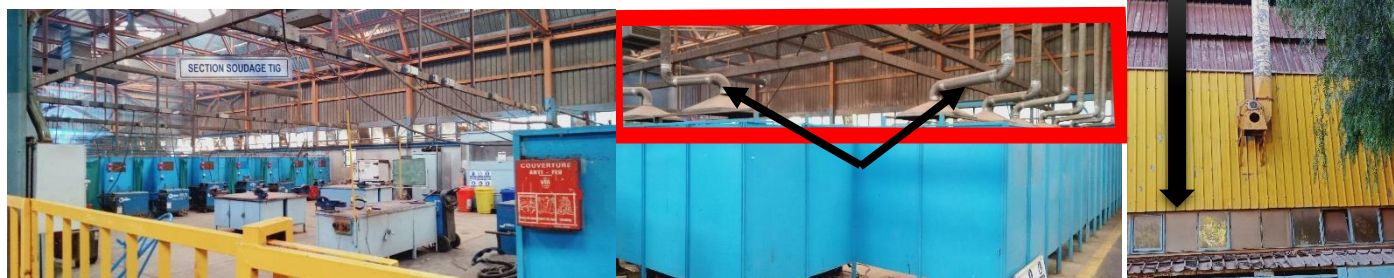
Figure II-22 : « aération des ateliers soudage, photos prise et traité par l'auteur »
