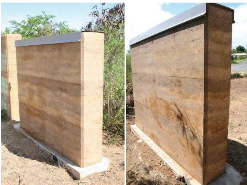
Figure V-5 : mur en béton de terre stabilisé, source Construction en Béton de Terre Stabilisé, Collège de Païamboué – Koné
