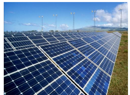
Figure 65 Les panneaux photovoltaïques
