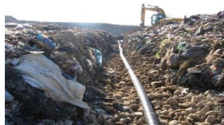
Figure 25 : des tranchées drainantes reliées aux puits verticaux, pour capter le biogaz en bordure de casier Source : http://www.sictom-bievre.fr ,consultée en ligne 05-2019
