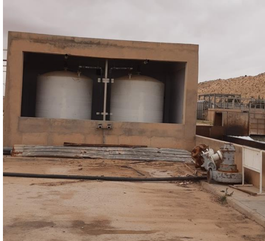
Fig14. Système d'injection de chlore pour le traitement des eaux usées
