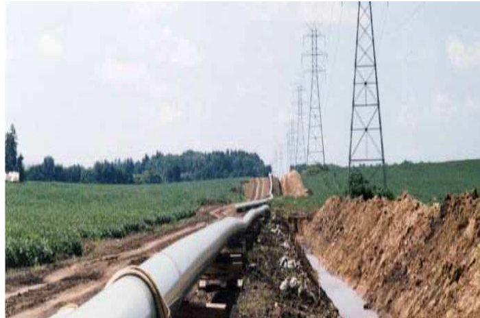
Figure II-3 : Présence d'une canalisation métallique de transport d'hydrocarbures dans un couloir de passage d'une ligne électrique à haute tension
