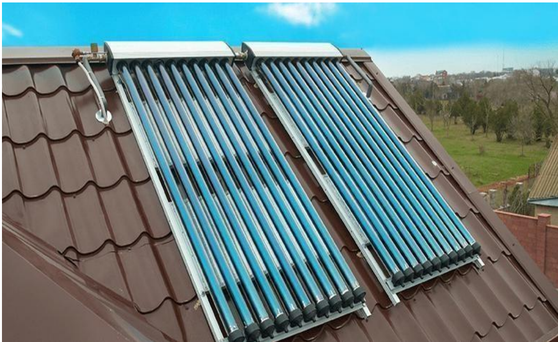
Figure I. 5 : Panneaux solaire thermiques [10]
