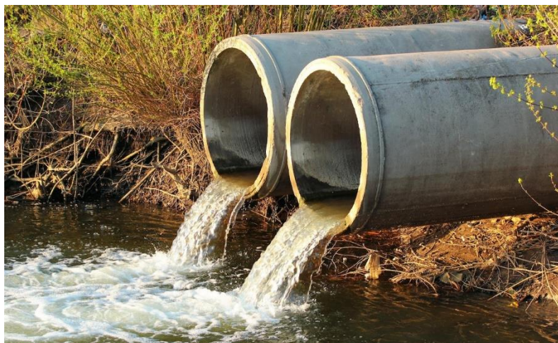
Figure I.1 : Déversement des eaux usées.
