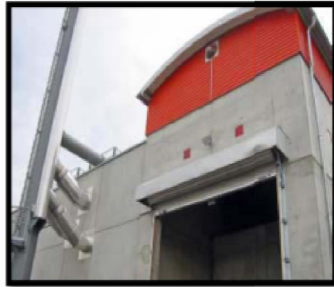
الشكل 1-40: الصورة توضح مركز توليد الطاقة.
