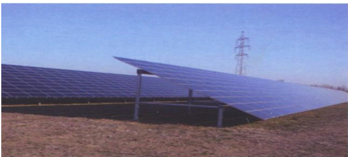
Centrale PV au sol (Narbonne - Aude) Source : Transénergie
