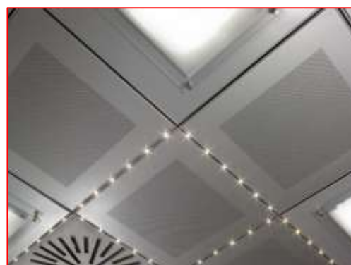
Figure IV.15 : faux plafond en aluminium Source : http://www.archiexpo.fr
