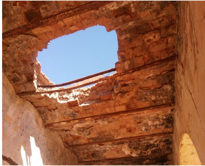
Fig.III.A.62. voutain endommagé Source auteur
