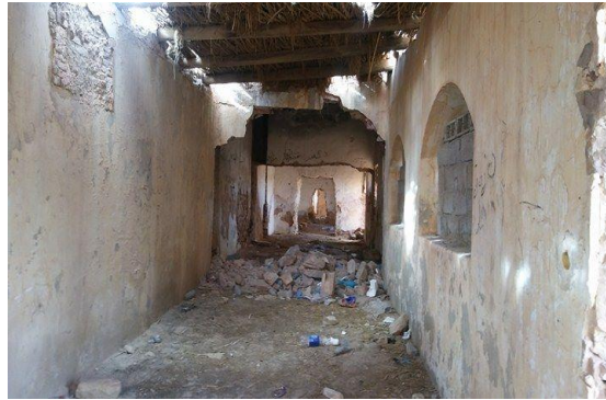
Fig.III.A.69 un espace endommagé
