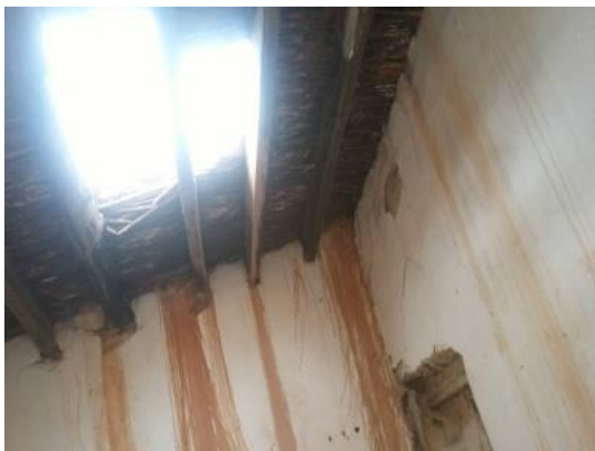
Fig. III.A. 32. effondrement du plancher
