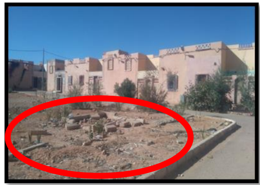
الصورة 63: ساحة لعب مخربة المصدر: الطلبة
