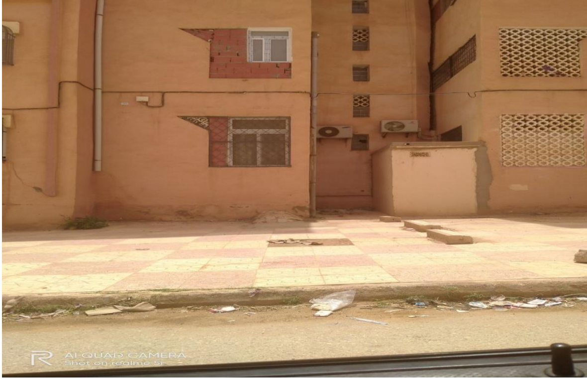
الصورة رقم 02 : توضح الترميمات على جدران عمارات حي 800 سكن
