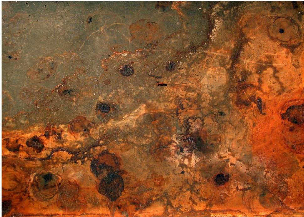
Figure I.1 : Image illustrative de l'état corrosif d'un morceau métallique.
