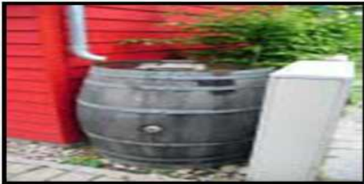
Photo 6 : une citerne de réservation des eaux
