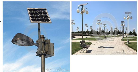
Ph.22. Poteau actionné solaire de lampe
