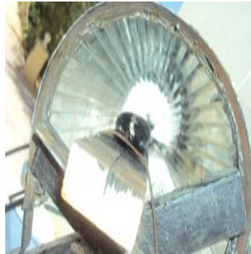
FigV.34. b : vu de l'échangeur sous le réflecteur auxiliaire
