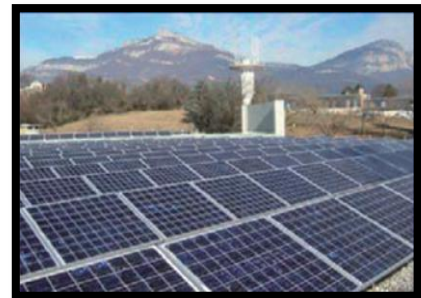
Figure 04 : panneaux solaires Source : guide_ecoconstruction
