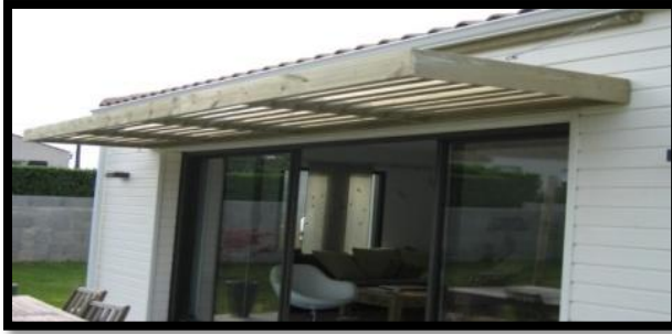
Figure 24 : brises solaires intégré dans une habitation, Source : www.helsinginenergia.fi/kaukolampo/ekoviikki.html
